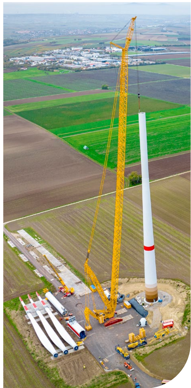
Die Errichtung einer Repowering-Anlage kann vereinfacht durch § 16b BImSchG genehmigt werden.
